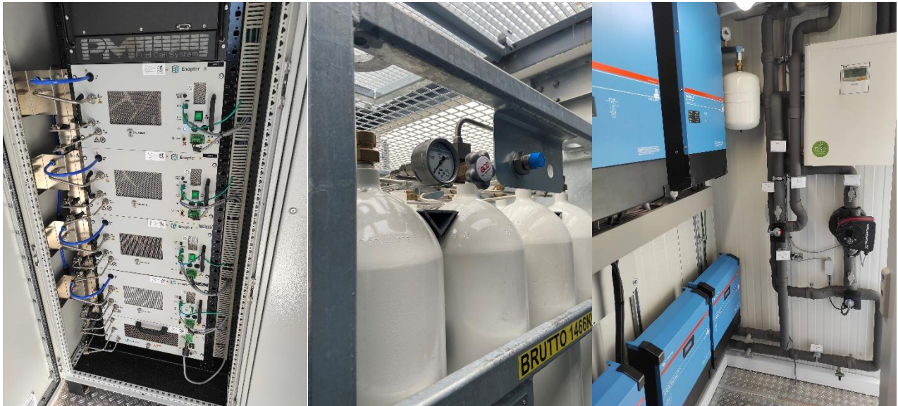
Abbildung 2: Teilsysteme des Microgrid (v.l.): Elektrolyseur, Wasserstoff-Speicher und Leistungselektronik
